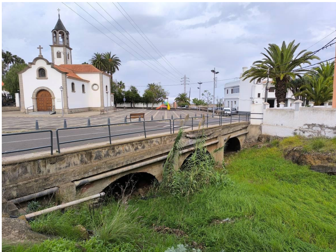
Figura 12. Aguas abajo del ámbito de actuación, pero a muy poca distancia, el Plan Especial de Defensa frente a Avenidas identifica un registro de riesgo por la escasa sección del cauce y de la obra de paso.
