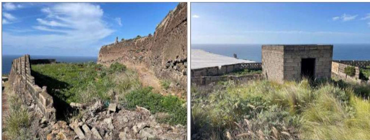
Figura 4. Detalles de muros cortavientos derruidos (izqda.) y edificación destinada originalmente a almacén (dcha.). Fuente: propia
