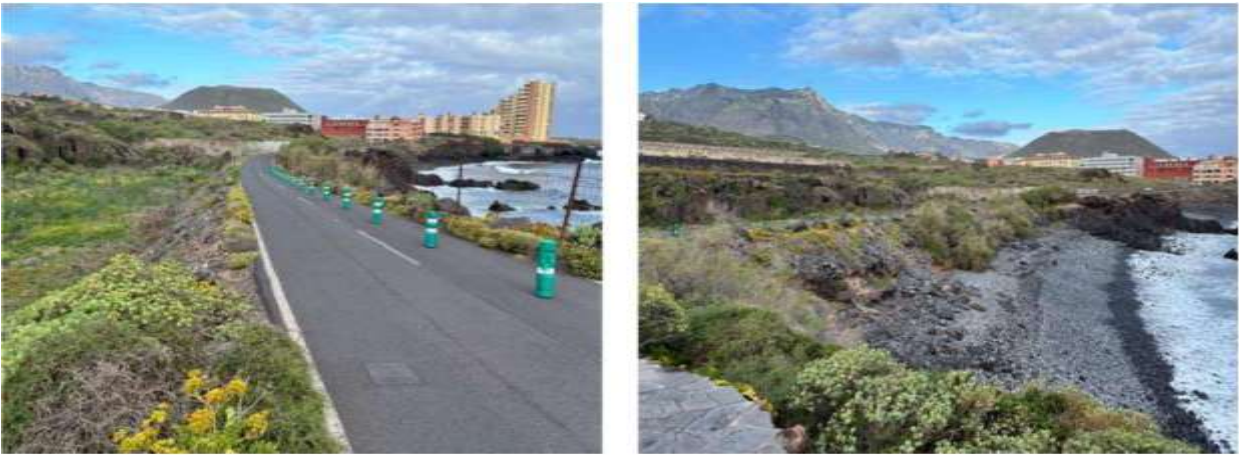
IMAGEN 4 y 5. SITUACION ACTUAL DE LA PLATAFORMA DEL CAMINO DE LA COSTA Y DEL TALUD LATERAL DEL TERRAPLEN BASE EJECUTADO SOBRE EL ESPACIO DE LA PLAYA.
