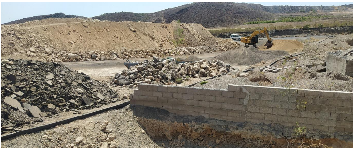
Impacto paisajístico y ambiental asociado a superficies de extracción de áridos y zonas de acopio
