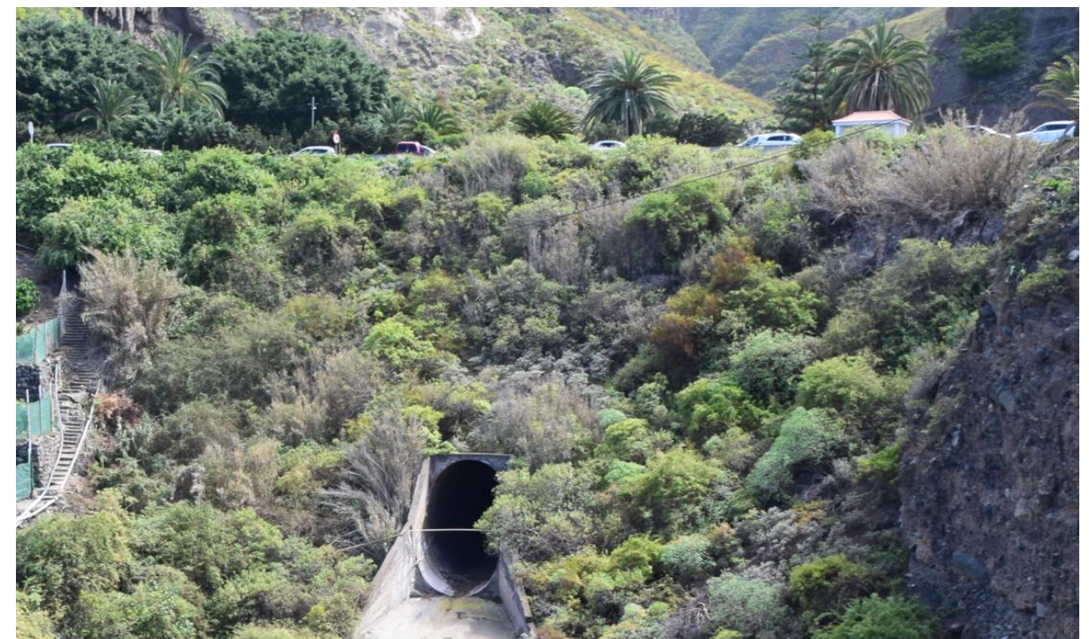
Foto 2. Presencia de cañaveral en lado mar de la TF-5 a la altura del Bco. de Ruiz
