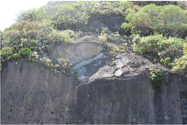
Foto 26. Bejeques en el talud al oeste del Área Recreativa
