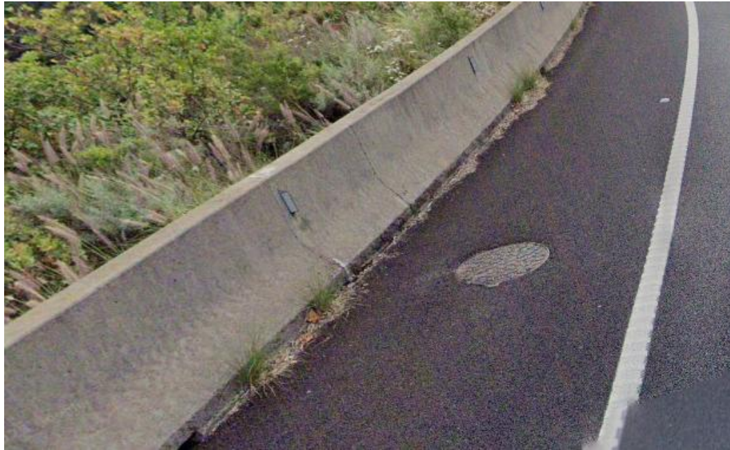
Imagen 108. Pozo de registro de la canalización de agua regenerada
