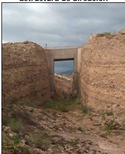
Estructura de aireación
