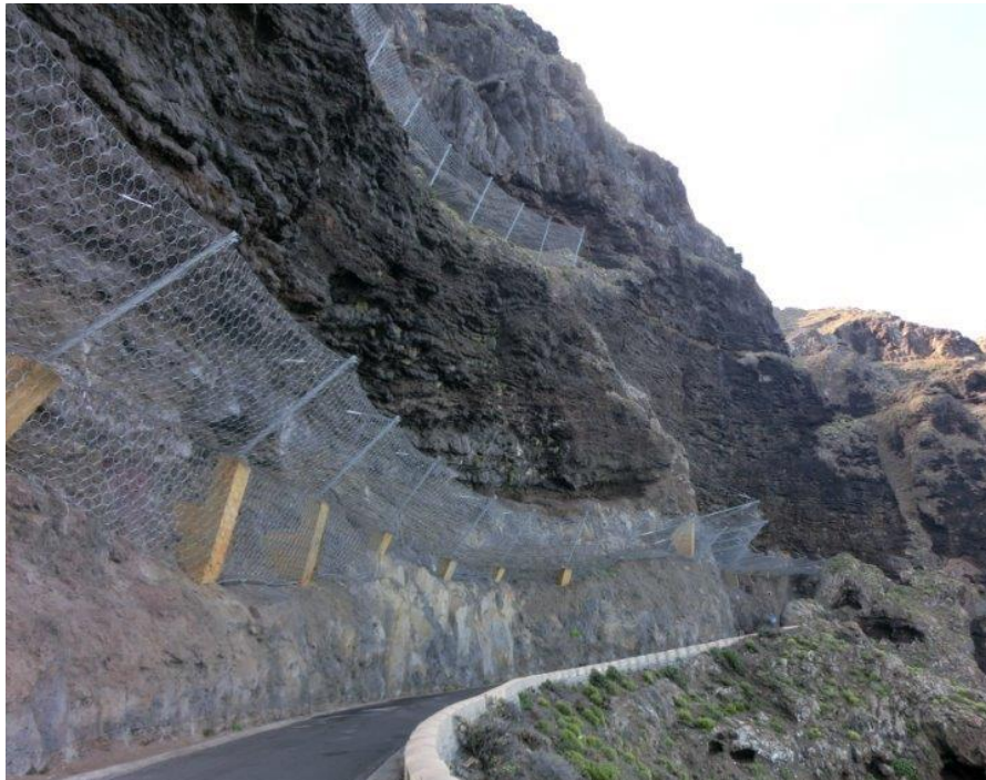
Figura 35: Mallas de contención colocadas sobre el hábitat (8220) Pendientes rocosas silíceas con vegetación casmofítica en la carretera de acceso a Punta Teno.
