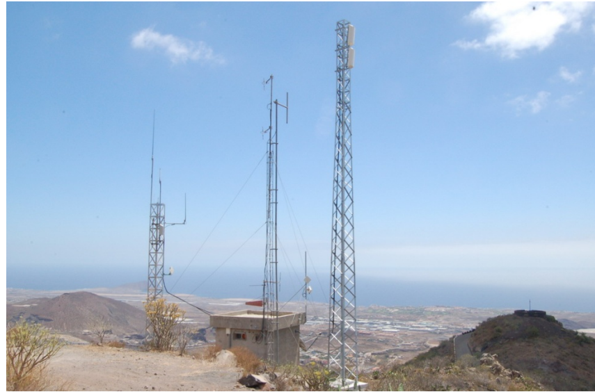
Foto N° 19: Torres con escaso número de antenas en Roque de Jama
