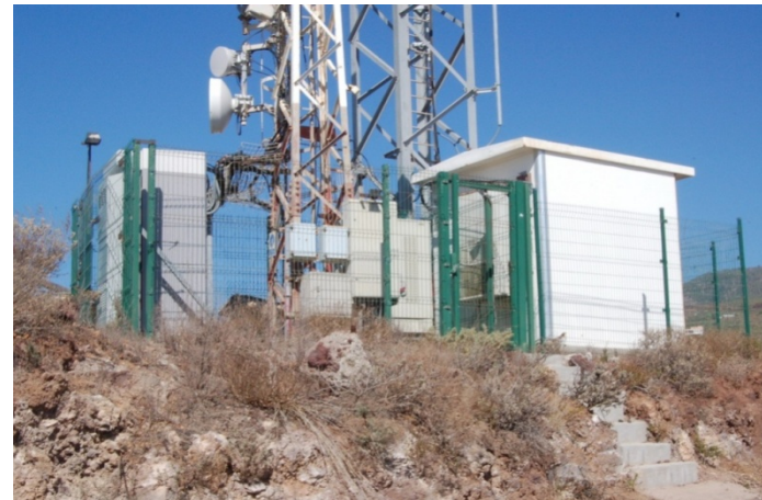
Foto N° 17: Escaso tratamiento de integración paisajística de casetas. Acojeja (Granadilla de Abona)
